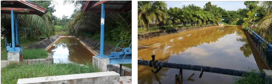
Gambar 3. Saluran Drainase dan Pintu Air Pada TWEP-KT
