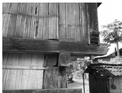
Gambar 10. Sambungan Kolom dan Balok tidak menerus
