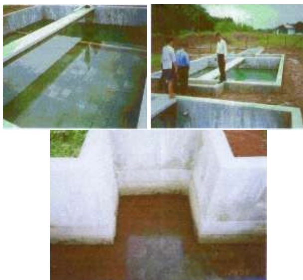
Gambar 9. Contoh konstruksi media biofilter, IPAL sistem biofilter, dan bak pemisah lemak.
